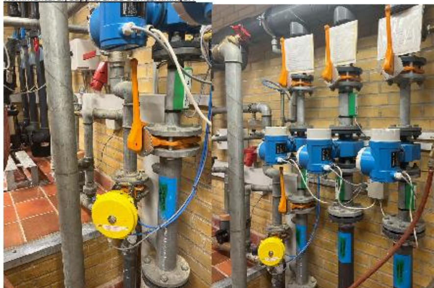
Grøn 'boks' er ultralydsanlæg 'kalkknuser'
