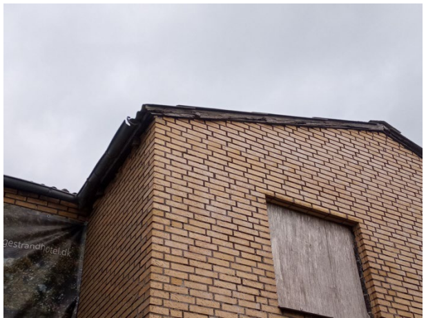
Råddent tagudhæng, adgangspunkt for flagermus til tagets hulrum
