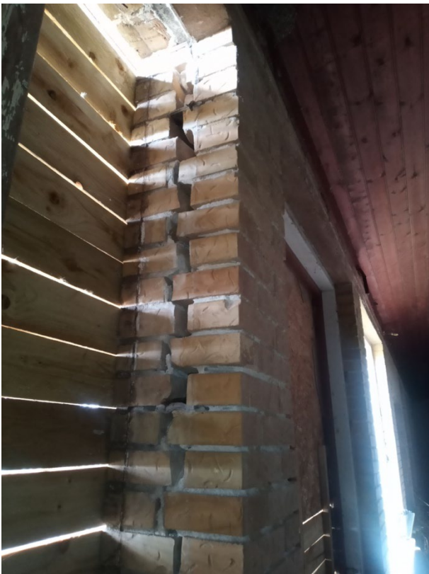
Store revner i murværk
