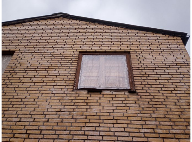
Huller under vinduesrammen
